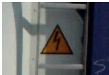
Figure 8.5 – Panneau de mise en garde contre les dangers au-dessus de la tête
