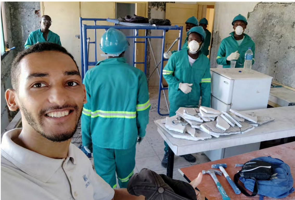
Le personnel du projet et des diplômés effectuent des travaux de démolition dans le bâtiment de la délégation.
