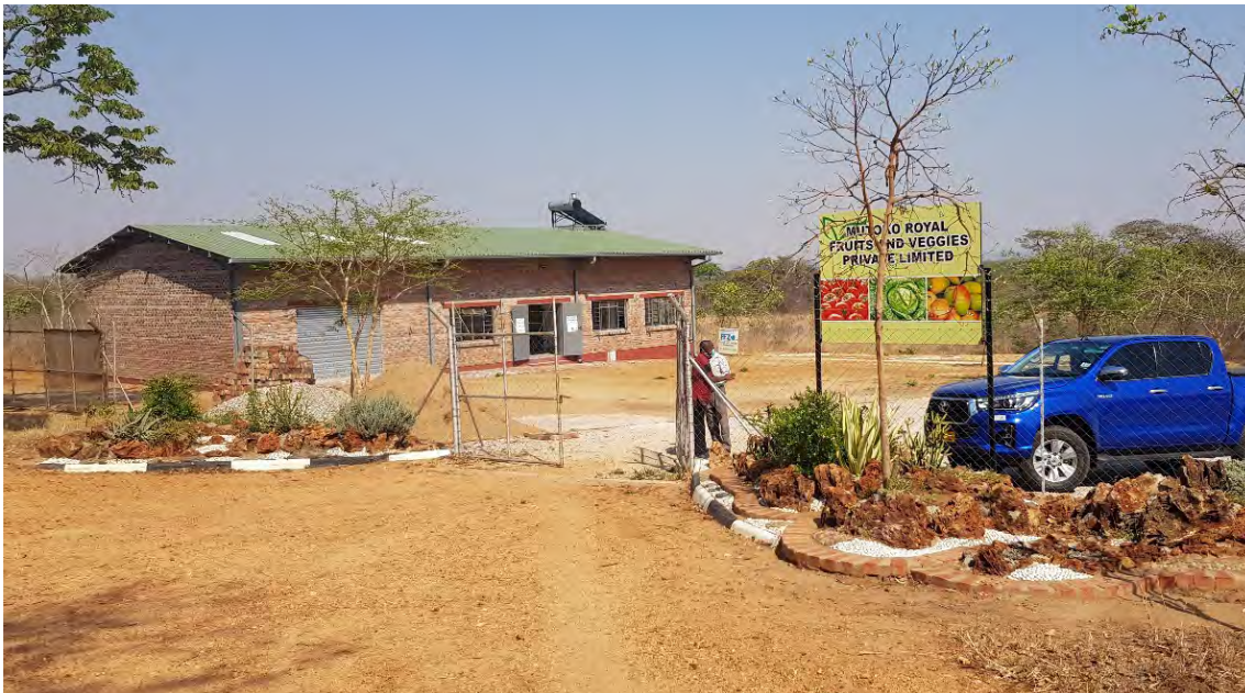
Travaux de construction dans un Centre de valorisation des fruits et légumes à Mutoko, Zimbabwe.
